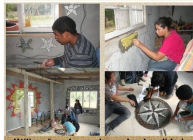
Utilização de pedras da localidade, toras de eucalipto reutilizadas, madeiras, tábuas e esquadrias reaproveitadas, mosaico.
